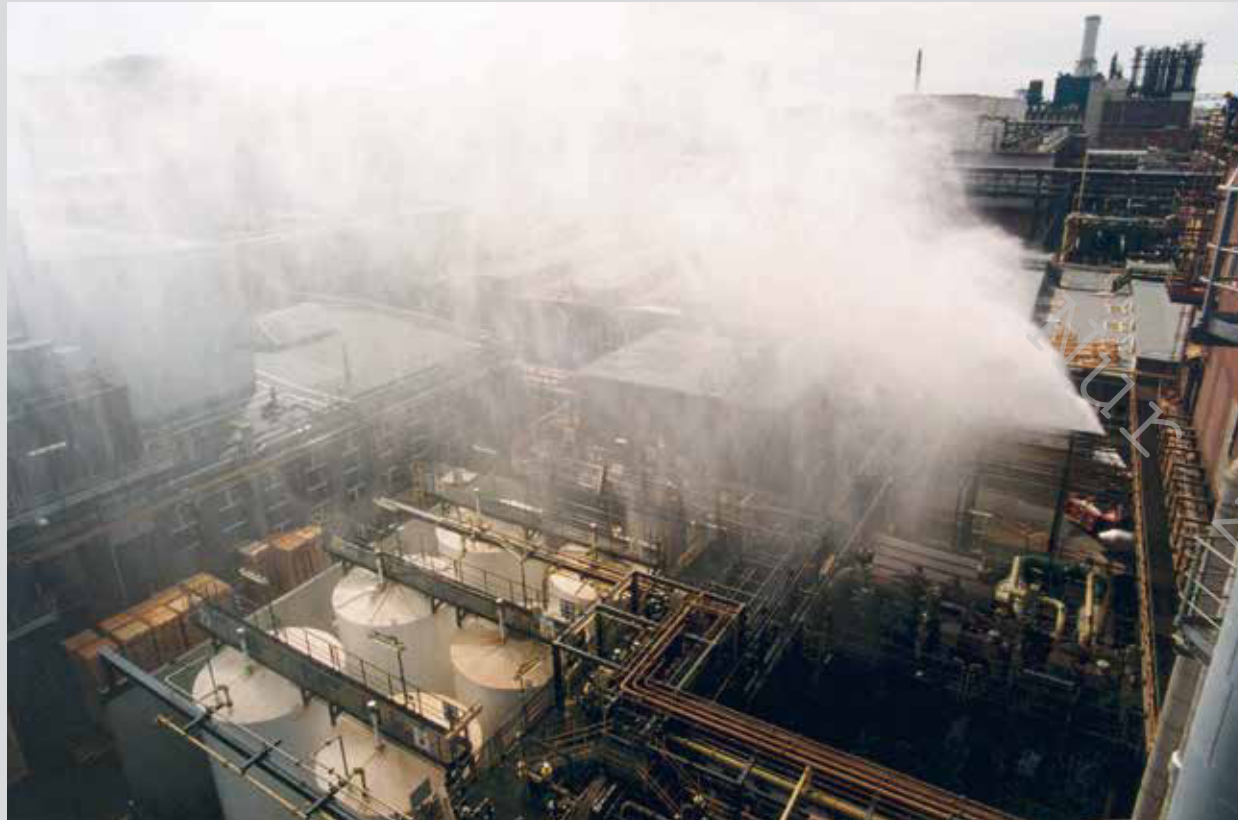
Hoher Nutzwert: Der Turbo-Löscher eignet sich hervorragend zur Kühlung hoch liegender Apparaturen und Rohrleitungen.
